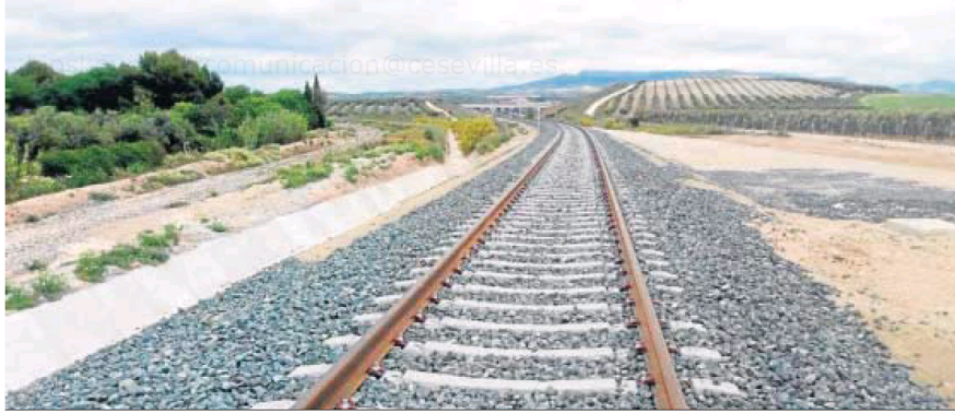
El tramo de casi 10 kilómetros que construyó Adif de Osuna a Pedrera por el eje ferroviario transversal propiedad de la Junta.
