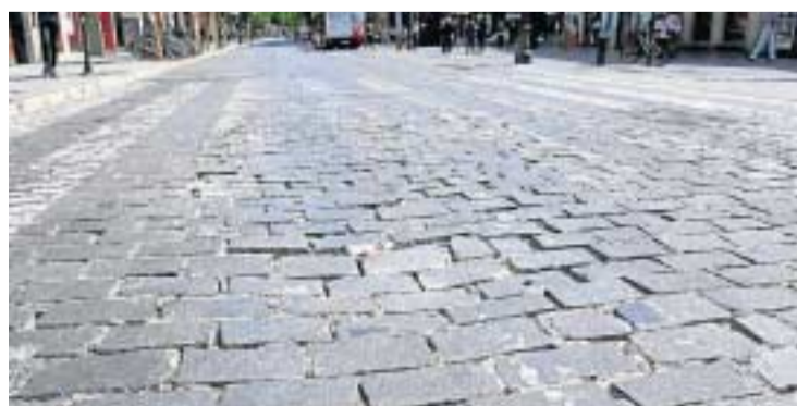
Un peligroso desnivel en el pavimento de la Campana.
