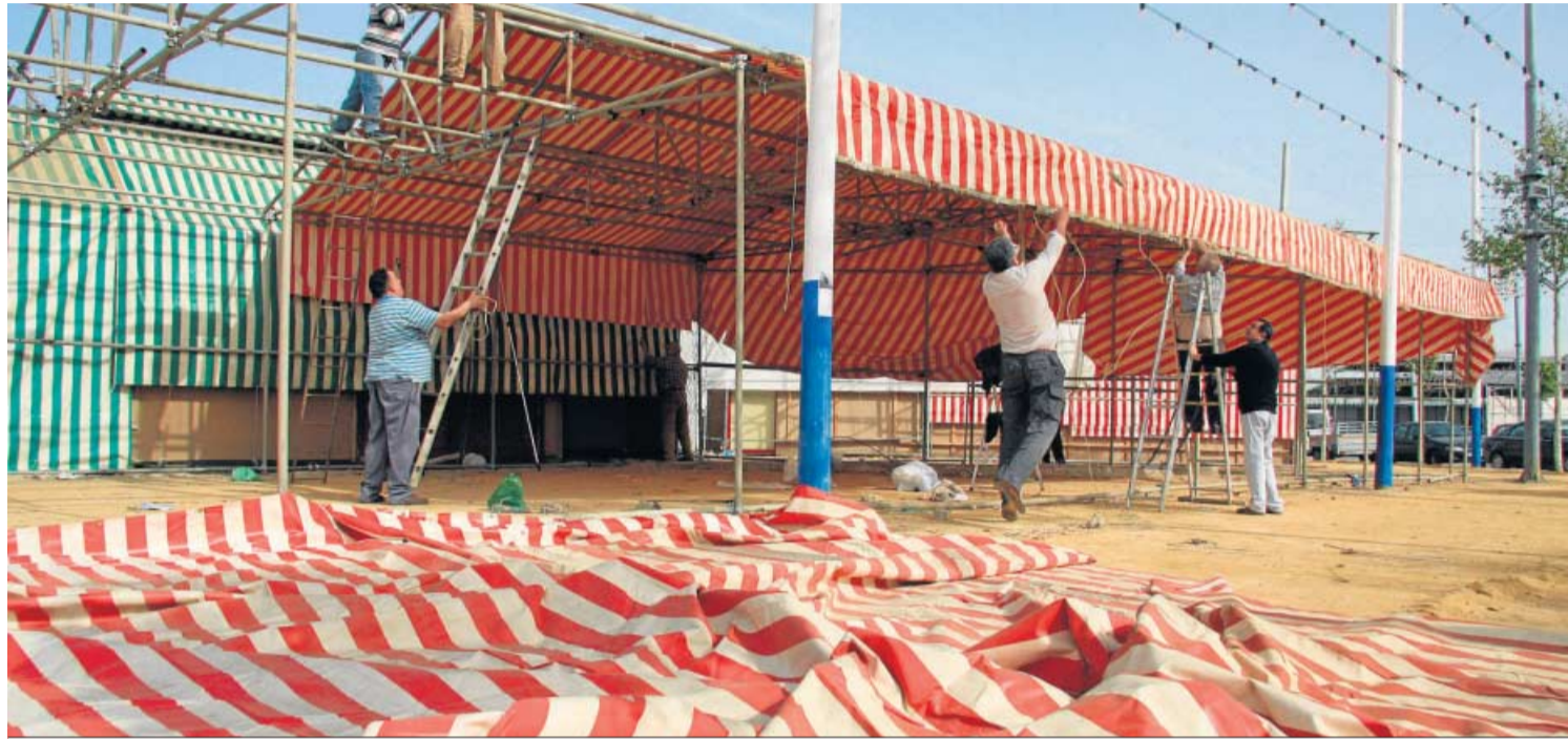
Montaje de la estructura de tubos en una caseta de la Feria.
