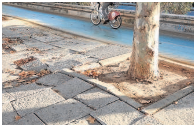
El estado del viario público es deficiente, como se ve en Torneo // VANESSA GÓMEZ
