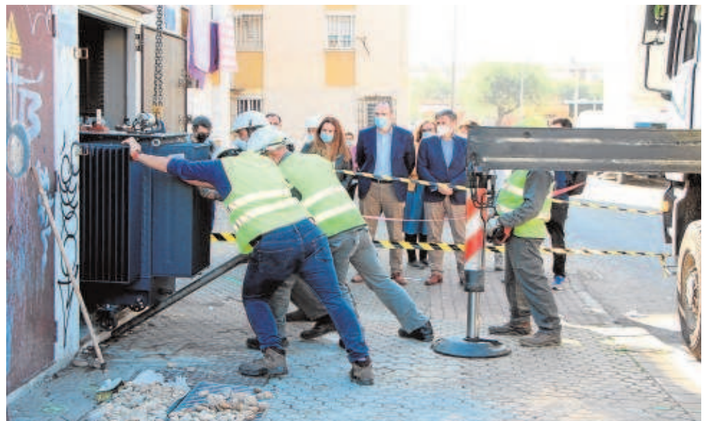
Técnicos de Endesa trabajan en el cambio de un centro de transformación en el Polígono Sur // ABC
