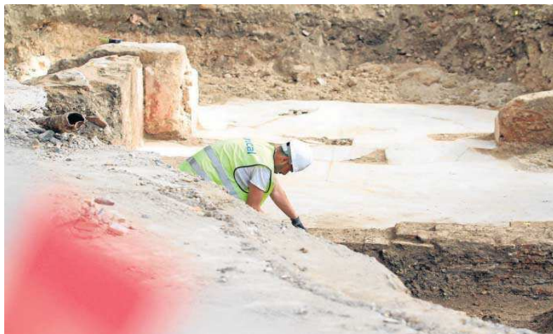
Un trabajador de la construcción en las obras del mercado de la Puerta de la Carne.
