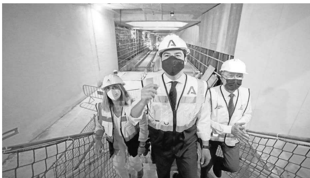
Juanma Moreno, flanqueado por Marifrán Carazo y Francisco de la Torre, ayer en las obras del metro de Málaga.
