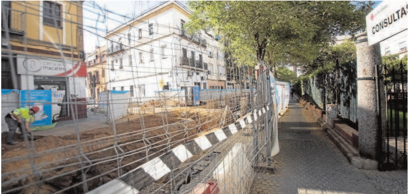
Obras de reurbanización, renovación de redes y peatonalización de la avenida Cruz Roja // ROCÍO RUZ
