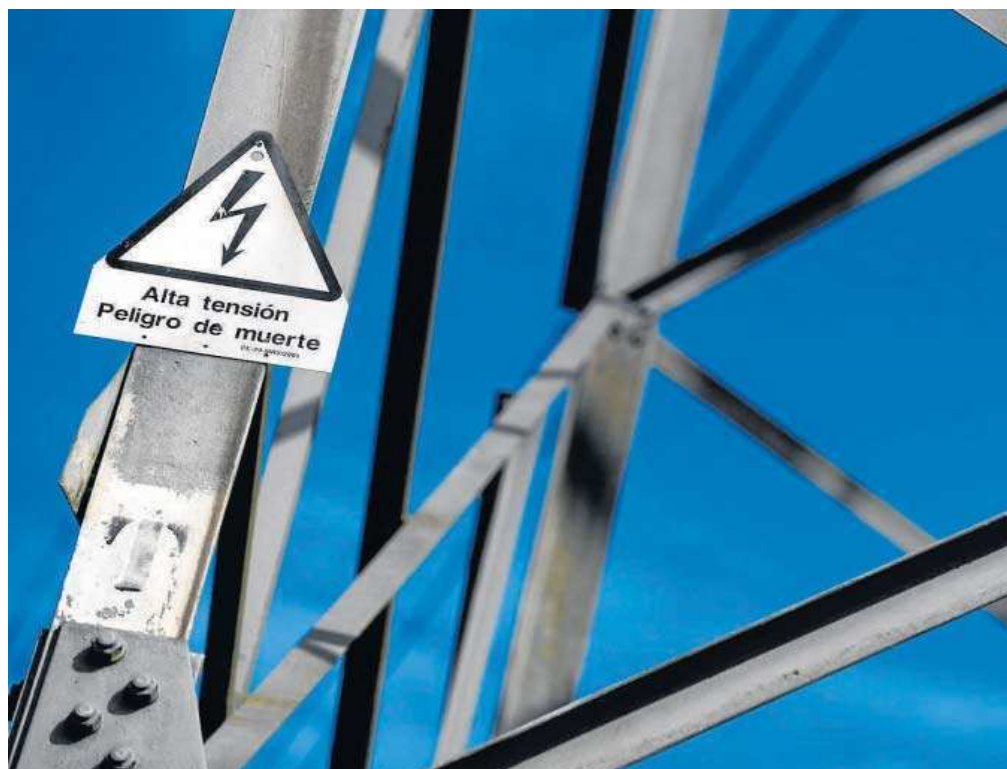
Una torre de transporte de la electricidad, en Asturias.
