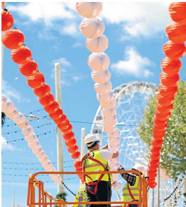
Un operario durante los trabajos de instalación de la iluminación de la Feria de Abril.
