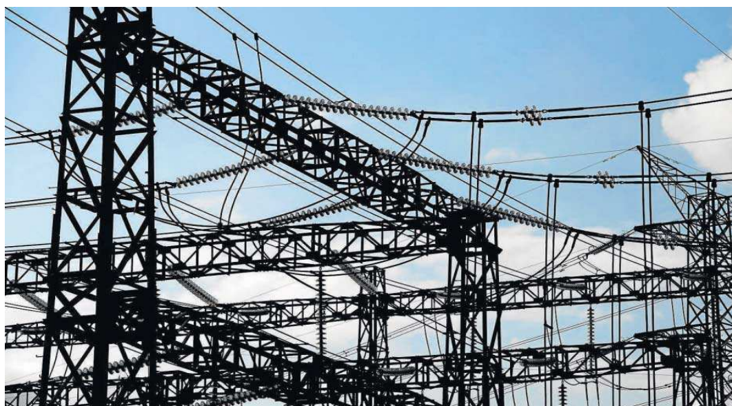
Instalaciones de una central de ciclo combinado en Asturias.
