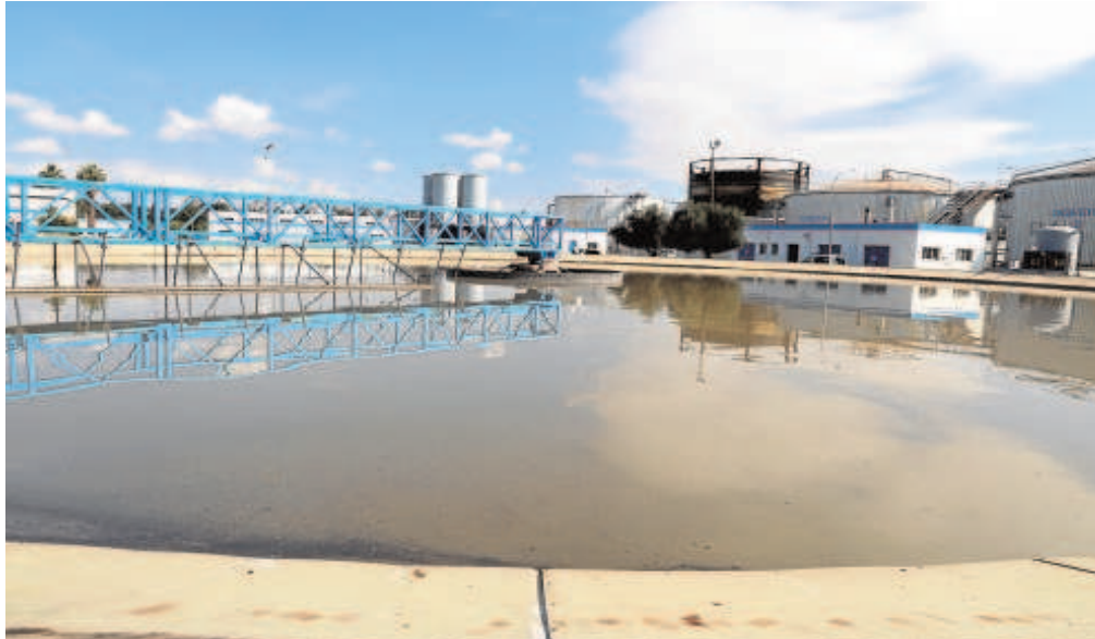
La estación depuradora de Emasesa de El Copero // ROCÍO RUZ
