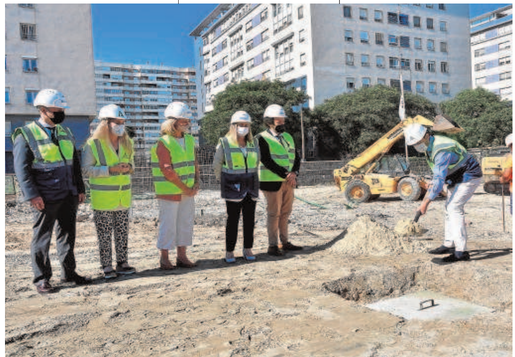
El presidente de la Junta, Juanma Moreno, en la primera piedra de la promoción de viviendas en Cádiz// ANTONIO VÁZQUEZ
