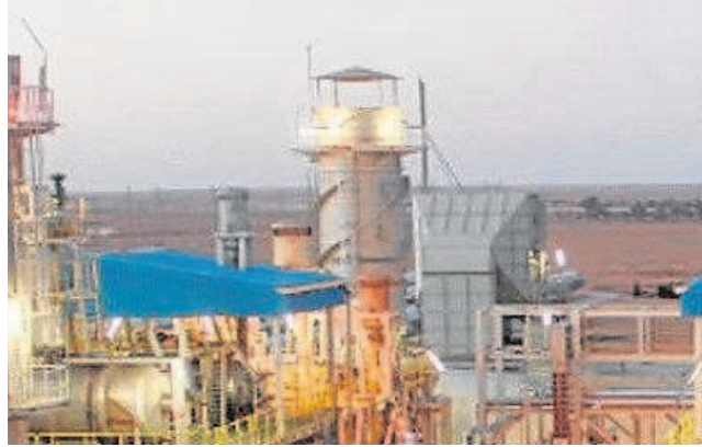
Abengoa opera desde 2011 la planta de ciclo combinado en Argelia // ABC
