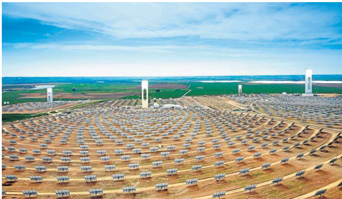
Complejo termosolar construido por Abengoa en Sanlúcar la Mayor.
