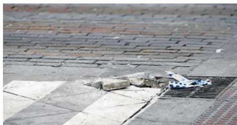
Pavimento roto en Los Remedios.
