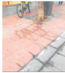
Restos de suciedad en el suelo.
