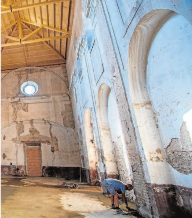
Sobre estas líneas, el interior de la iglesia de San Laureano tras las obras de reconstrucción de la cubierta y de estabilización de 2020. A la derecha, una de las pinturas murales aparecidas. Debajo, el atrio de acceso, que está clausurado por un muro e impide la entrada a los vecinos // ABEKOCO / JUAN FLORES
