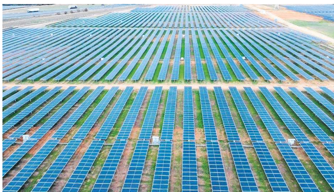
Imagen de la planta fotovoltaica de Endesa Torrepalma.
