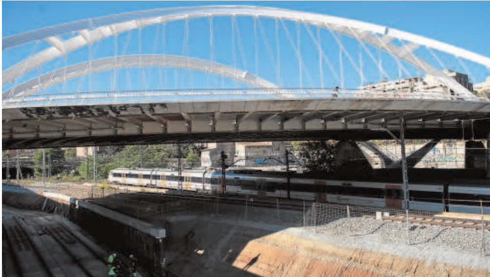
Obras del tren de alta velocidad en la provincia de Barcelona // INÉS BAUCELLS
