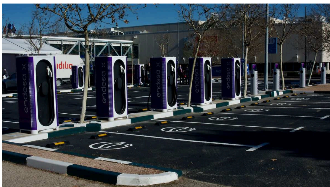
La infraestructura dispone de diez puntos de carga de 150 kW y trece de 22 kW, cada uno de ellos puede dar servicio a dos coches simultáneamente.
