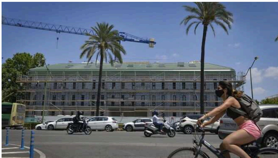
Obras en una de las residencias de estudiantes de la Avenida de la Palmera la primavera pasada.
