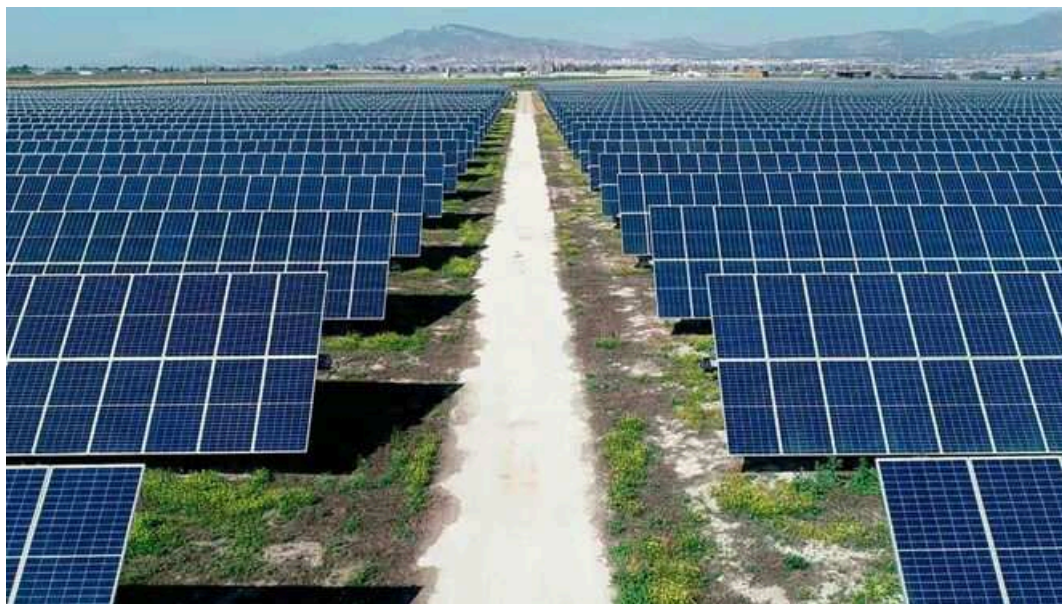
Planta de placas solares de Endesa.
