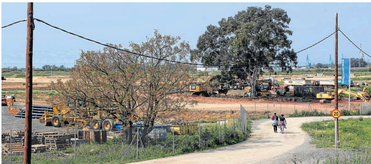
Una pareja camina por una senda que discurre por los terrenos de Palmas Altas Sur, donde se construirán las viviendas protegidas.
