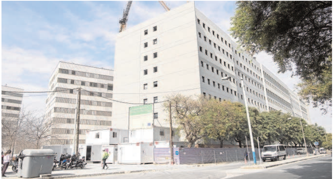
La enorme residencia estudiantil de Grupo Moraval se ha levantado sobre las antiguas cocheras de Tussam // FOTOS: ROCÍO RUZ
