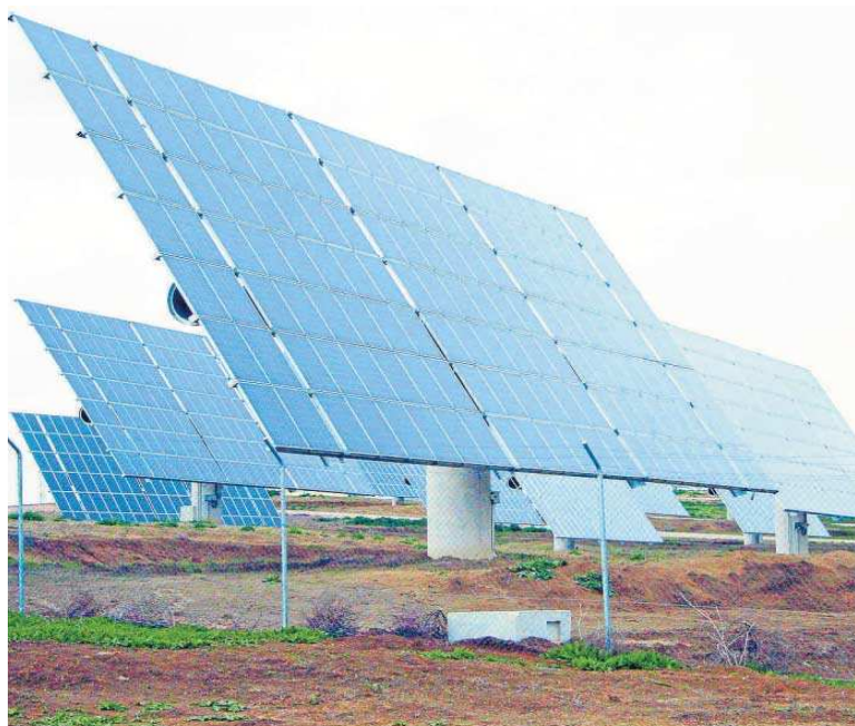
Una planta fotovoltaica en El Coronil, en la provincia de Sevilla.
