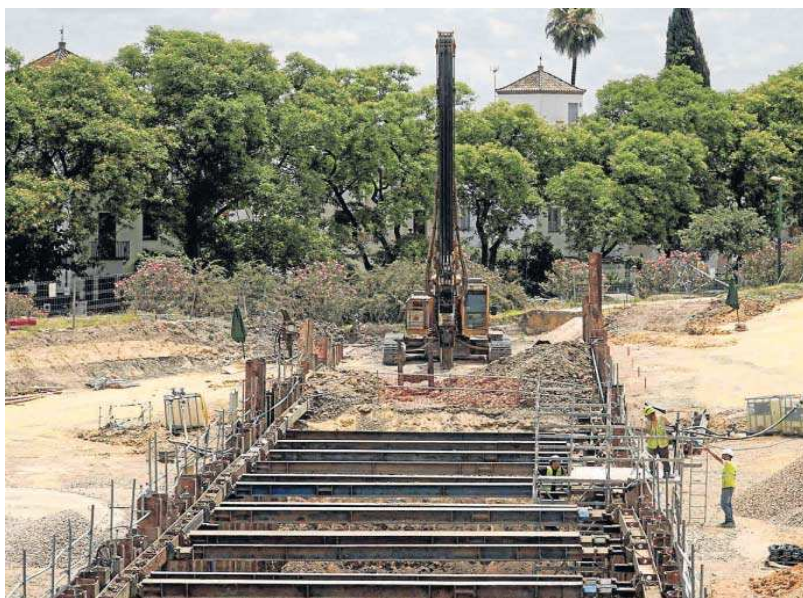
Primer plano de la zanja de 8 metros de profundidad abierta en el parque a la altura de Padre García Tejero.
