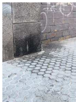
Acera llena de suciedad.
