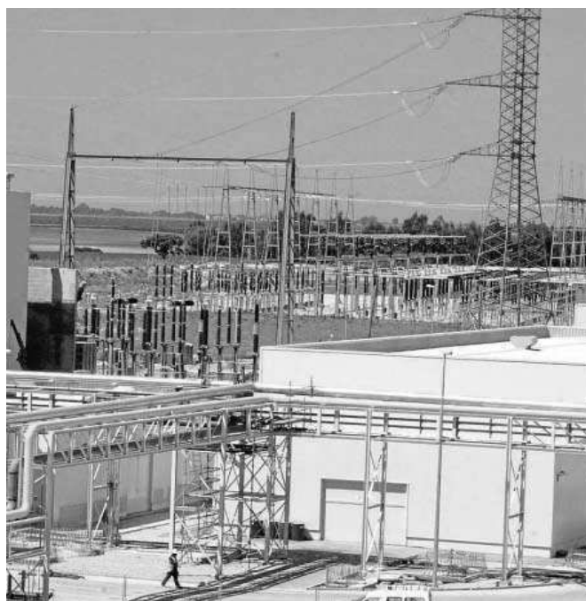
Subestación de red eléctrica.
