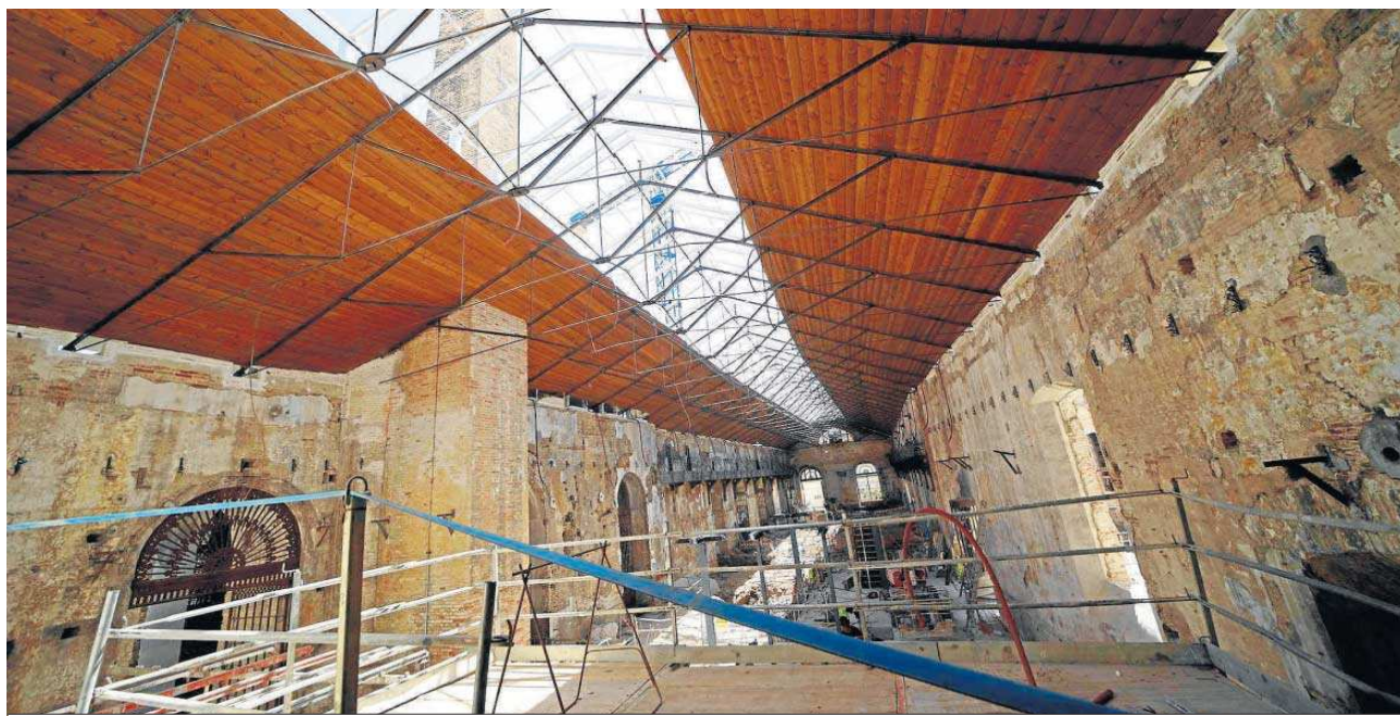
Sala de Crisoles, con el forjado y la cubierta original y ya restaurado. Al fondo se han hallado los restos de una villa romana que también se contempla excavar.
