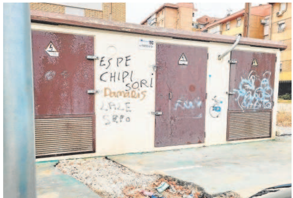
Un transformador instalado por Endesa que duró una semana sin sufrir un enganche// ABC
