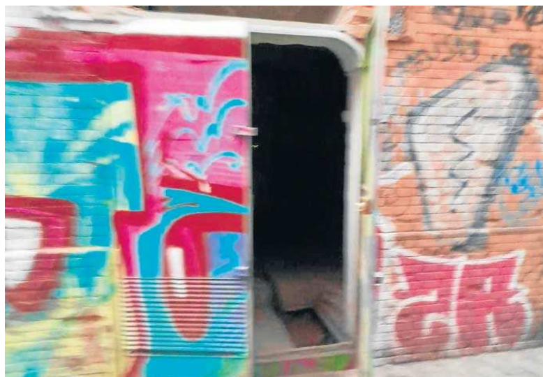
El centro de transformación de Endesa en la calle González Cuadrado, con las puertas abiertas.
