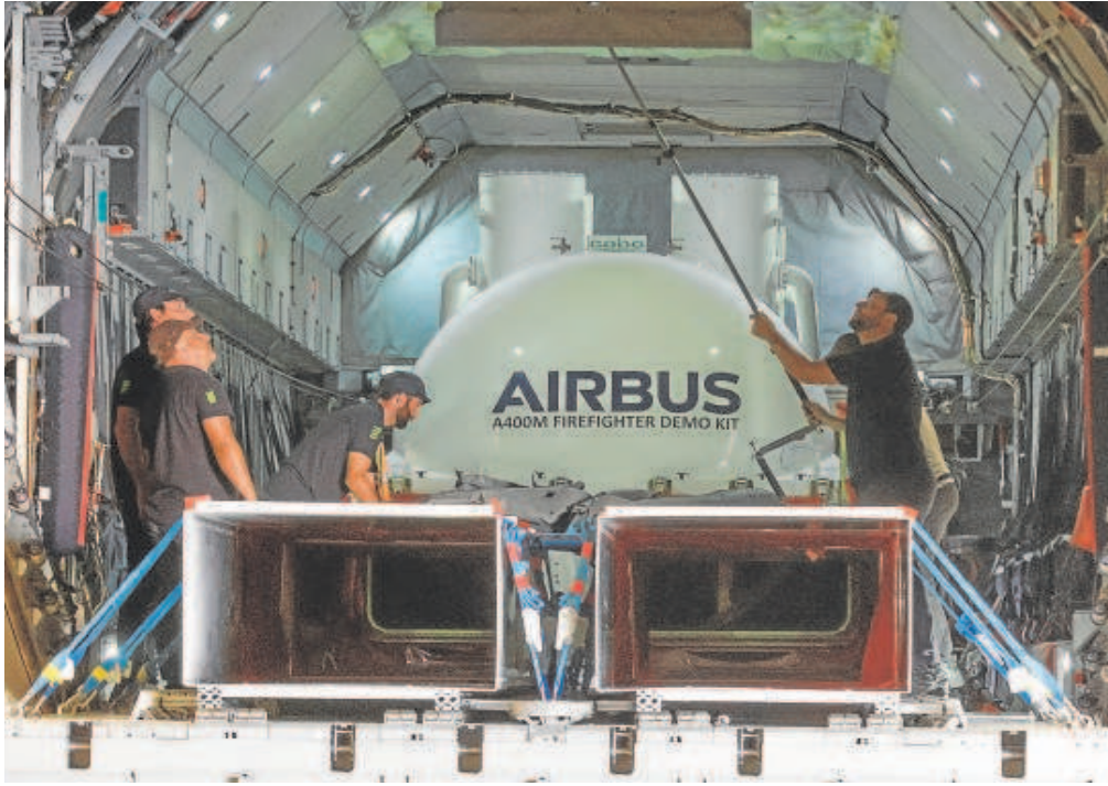
Técnicos de Airbus instalan el tanque de agua en un A400M en la factoría sevillana de San Pablo // MANUEL GÓMEZ
