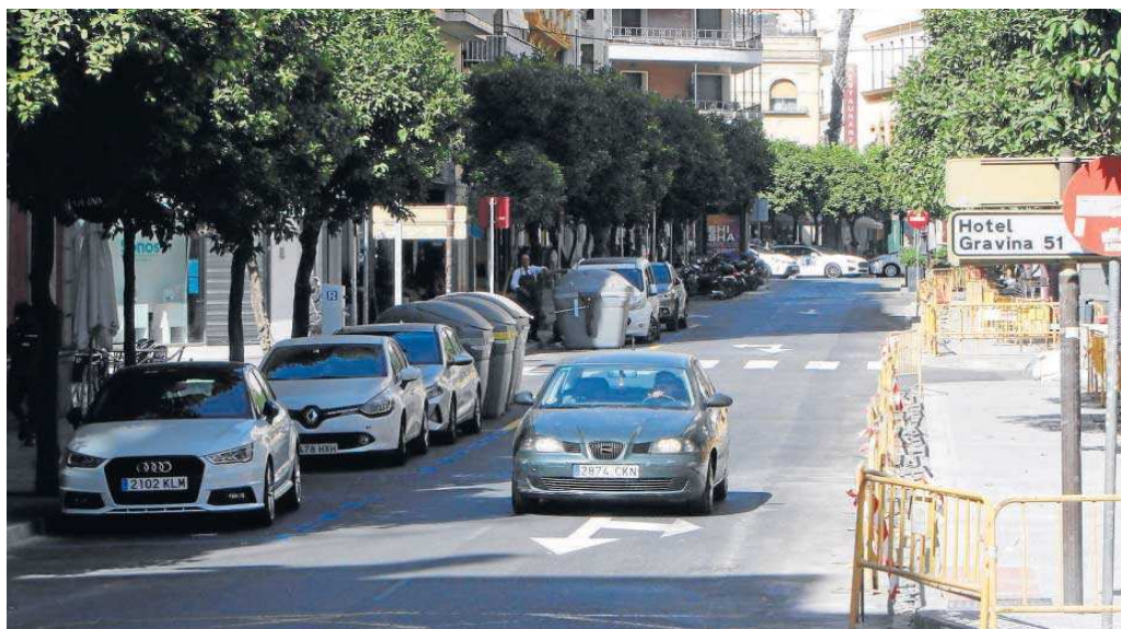
Un coche circula por el único carril que quedará habitado en la calle Canalejas tras las obras de reurbanización.
