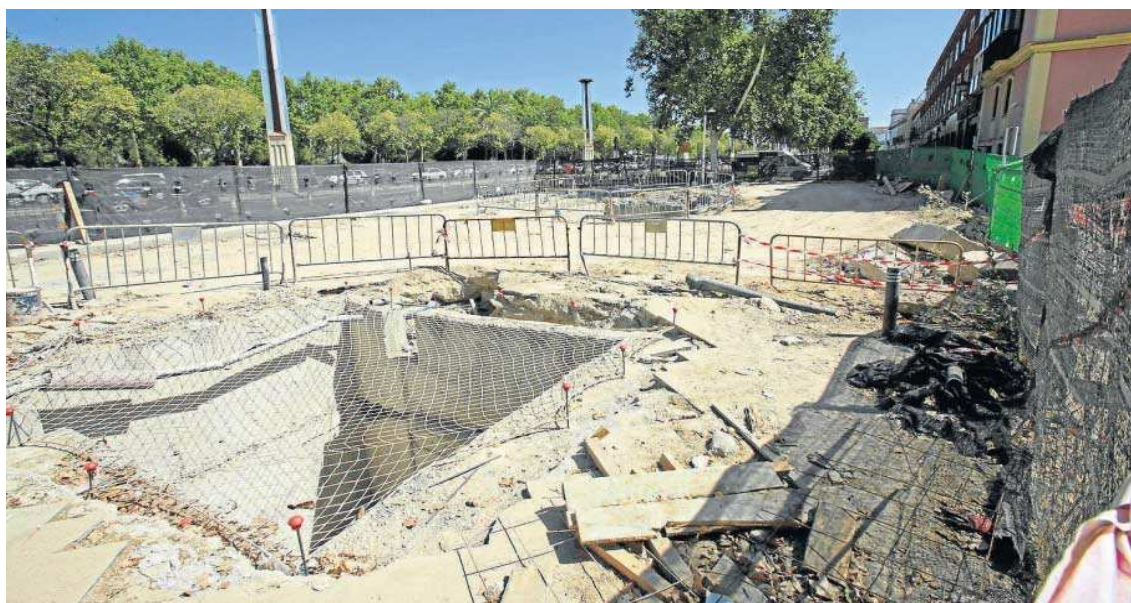
La arqueta abierta en la calle Lumbreras por la que salió la tuneladora el pasado 28 de junio tras ejecutar el túnel.
