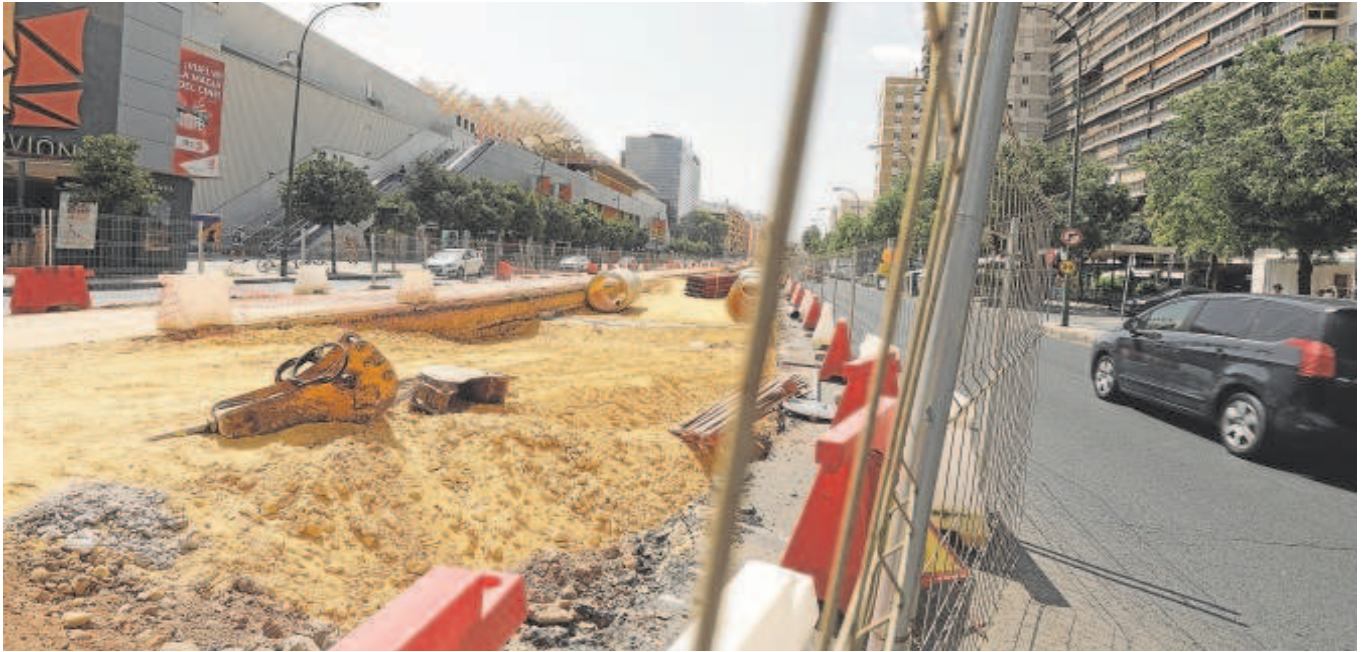
Estado actual de las obras de ampliación del tranvía en la avenida Luis de Morales // RAÚL DOBLADO
