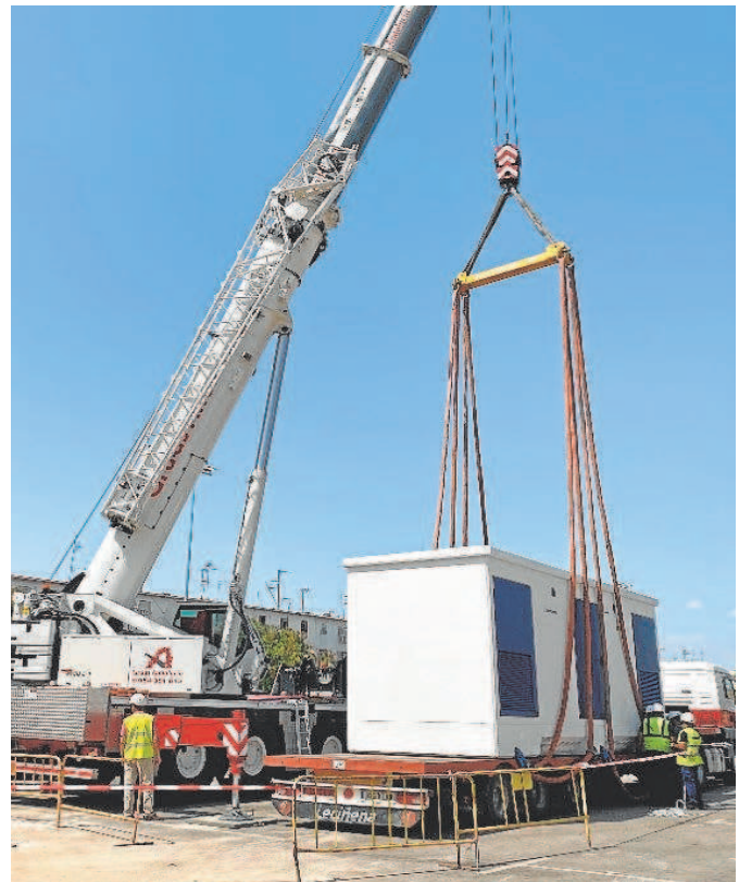
Uno de los centros de transformación que ha instalado Endesa // ABC
