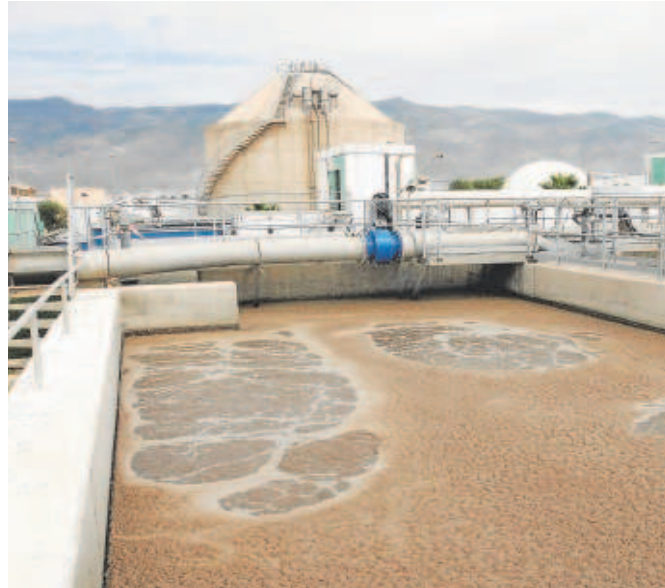
Estación depuradora de aguas residuales de El Ejido, Almería // EFE/CARLOS BARBA
