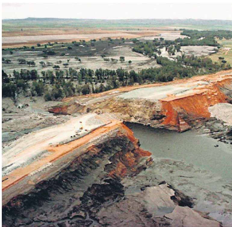
Rotura en el muro de la balsa de la mina de Aznalcóllar.
