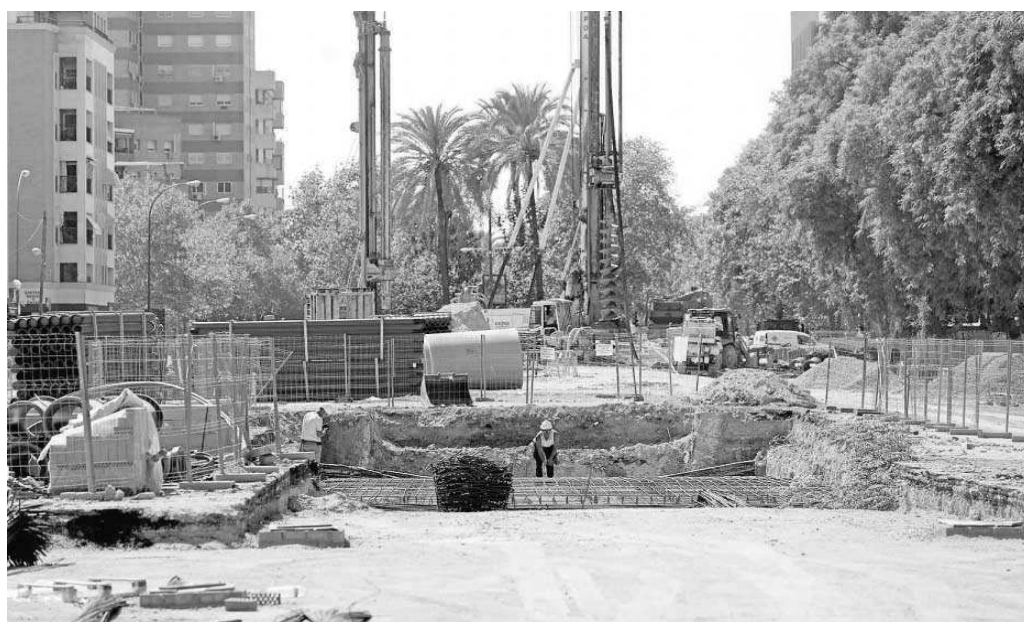
Estado actual de las obras del tranvía en San Francisco Javier, ayer lunes.
