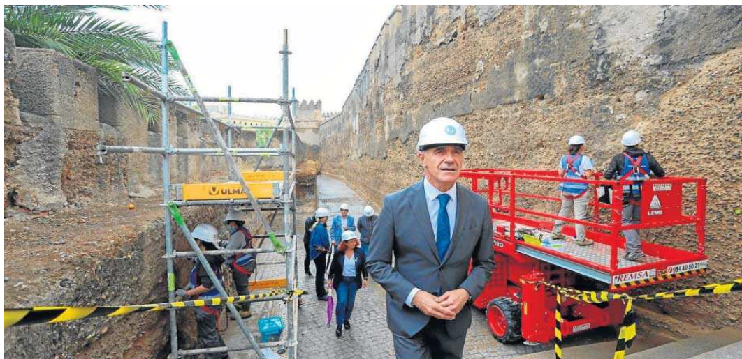
Antonio Muñoz, durante la visita realizada ayer al inicio de las obras.
