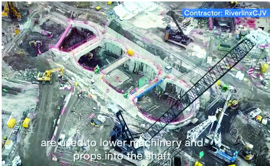
El pozo de ataque de la tuneladora del proyecto de Silvertown para el que sí hay experiencia.
