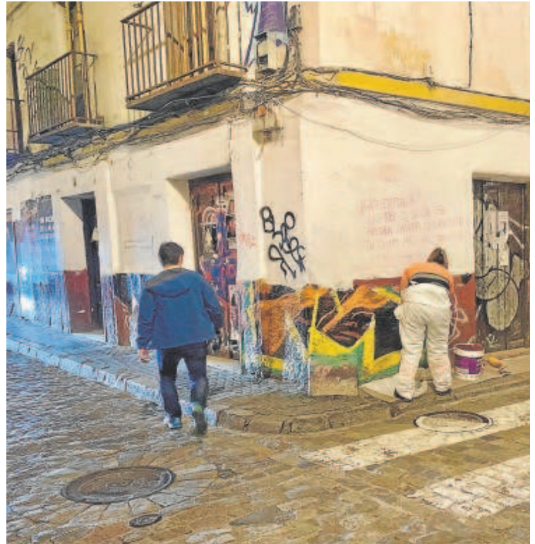
Una operaria de Lipasam actuando en la fachada de un edificio vandalizado en la calle
