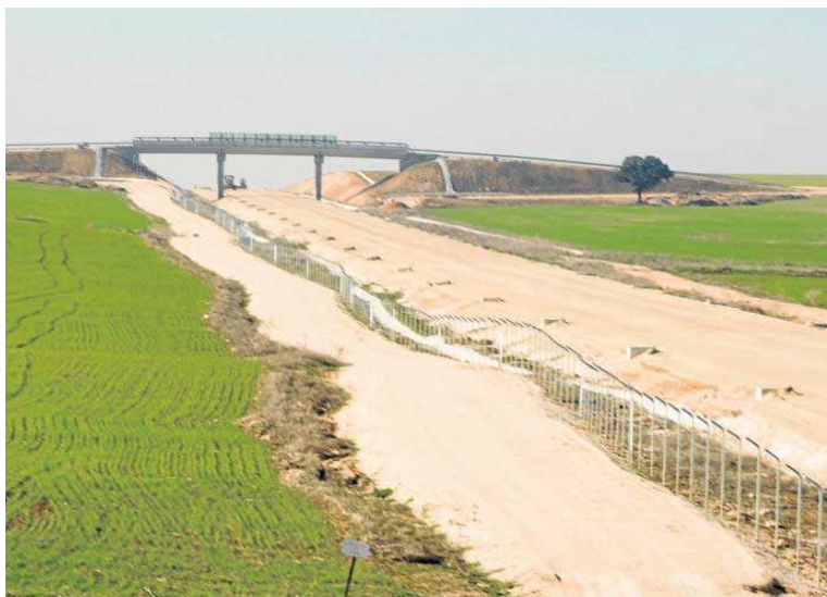
La plataforma terriza que se construyó en época de Chaves para el AVE Sevilla-Antequera.
