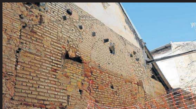
LA CUBIERTA. El muro exterior de la cabecera del templo evidencia la altura primitiva de la sinagoga (en ladrillo), sobre la que se dispuso en el XVII el artesanado que se ha conservado.
