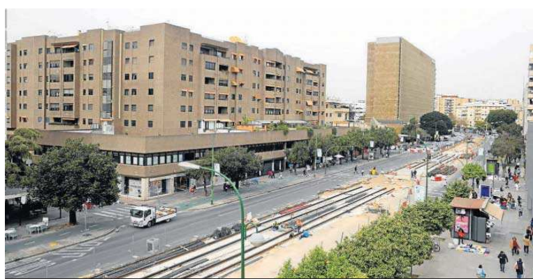
Luis de Morales sin coches. Solo con los trabajos de construcción del tranvía.
