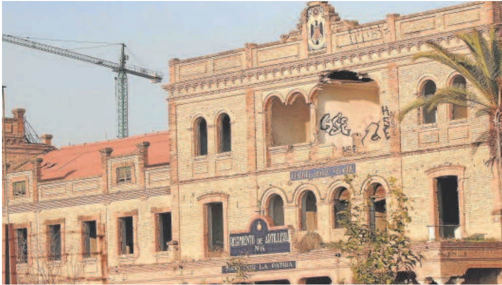
Estado actual que presenta las instalaciones del cuartel de Artillería Daoiz y Velarde // JUAN FLORES
