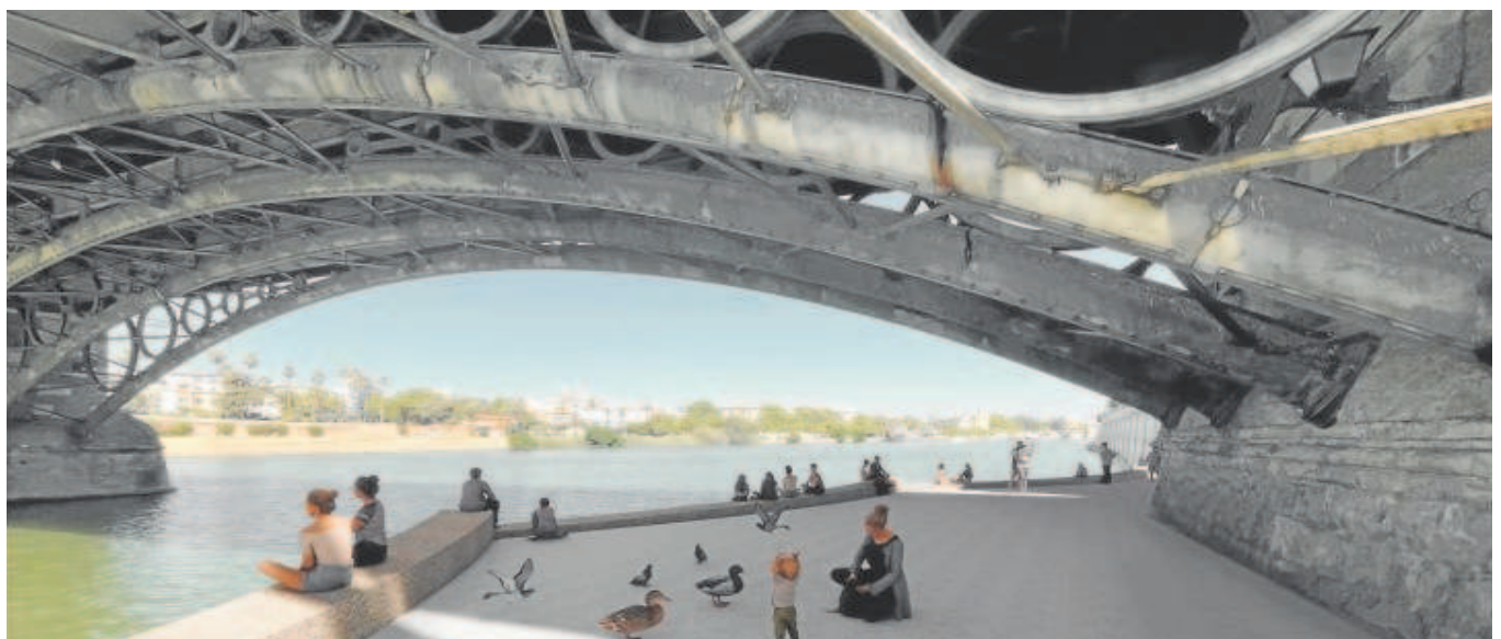
Recreación del Paseo de la O bajo la zapata del puente de Triana una vez que sea reordenado // ABC
