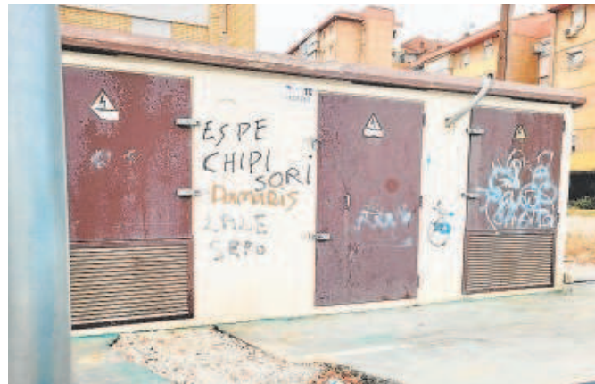
Uno de los transformadores de la zona de Polígono Sur // ABC
