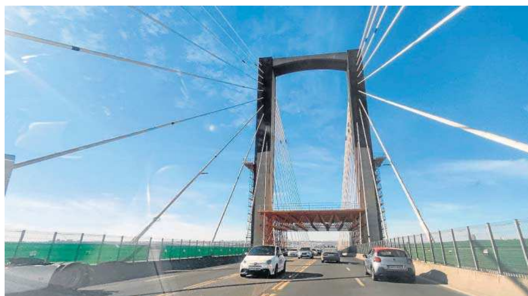
Primer plano de las estructuras colocadas para trabajar en la cota superior del puente, el pasado viernes. FOTOS: JUAN CARLOS MUÑOZ
