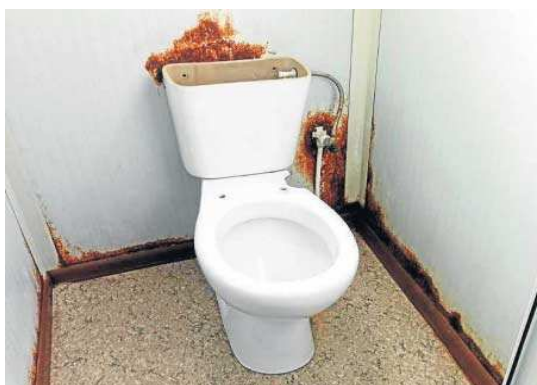
Un aseo del comedor, donde se percibe el moho de las instalaciones. D. S.
