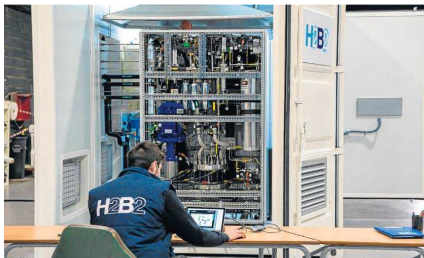
Un electrolizador construido por H2B2.
