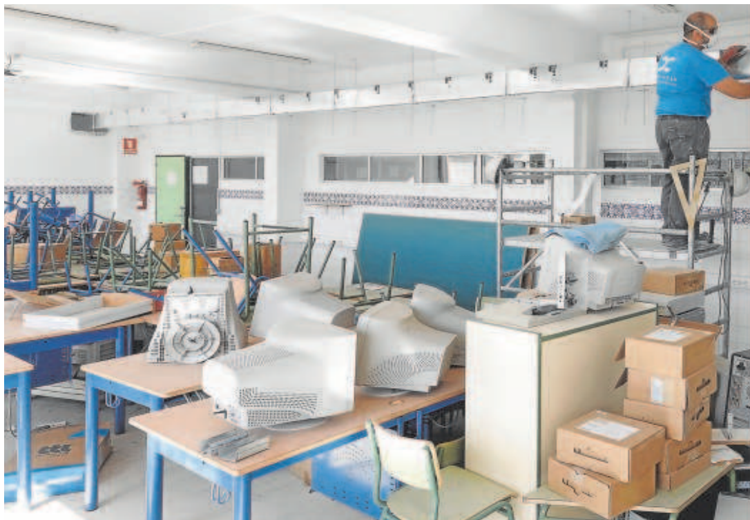
Dos operarios instalan las conducciones de climatización de un colegio de Córdoba // VALERIO MERINO
