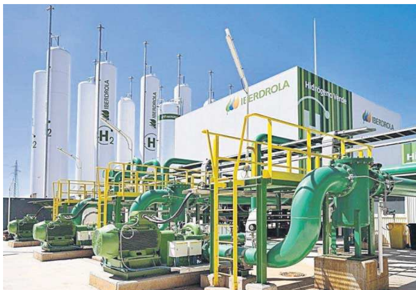
Planta de hidrógeno verde de Iberdrola.
