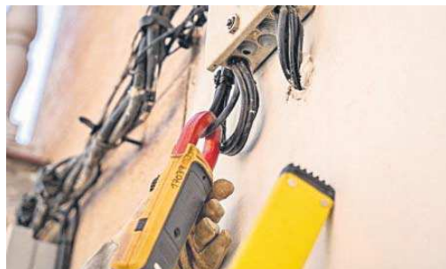
Detalle de la pinza amperimétrica con la que se mide la corriente.
