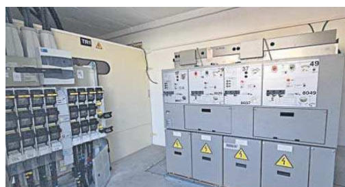
Interior de uno de los nueve nuevos centros de transformación instalados.
